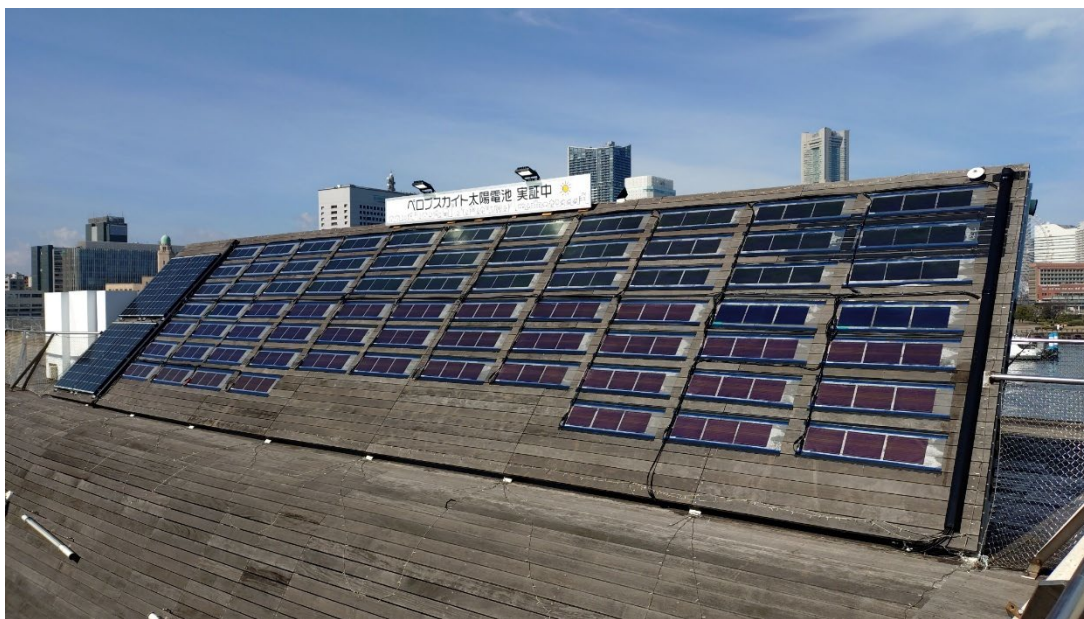
図 6. 横浜港大さん橋国際客船ターミナル屋上広場に設置されているペロブスカイト太陽電池モジュール。モジュールサイズは 30cm×1m。
