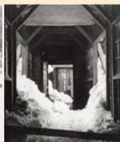
法学部の建物内部に吹き込んだ雪
