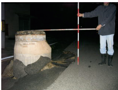
マンホールの浮上
