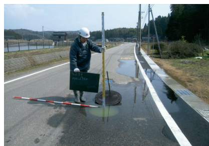
マンホールからの漏水
