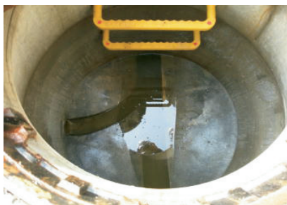
マンホール内滞水
