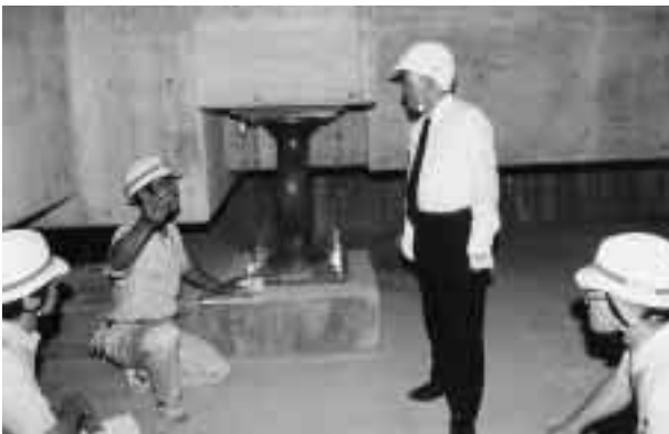
地下1階の柱直下に配置する免震装置を視察する岡田学長 = 7月30日、医学部附属病院で
